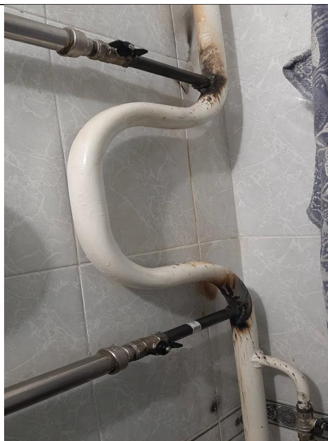
ФОТО №12 (Следы коррозии на отводах и в местах изгибов труб.)
