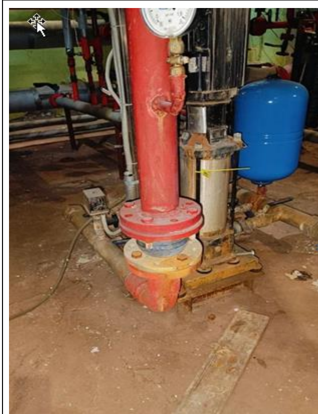
ФОТО №1 (Узел трубопровода ГВС в ИТП, коррозия наружной поверхности).
