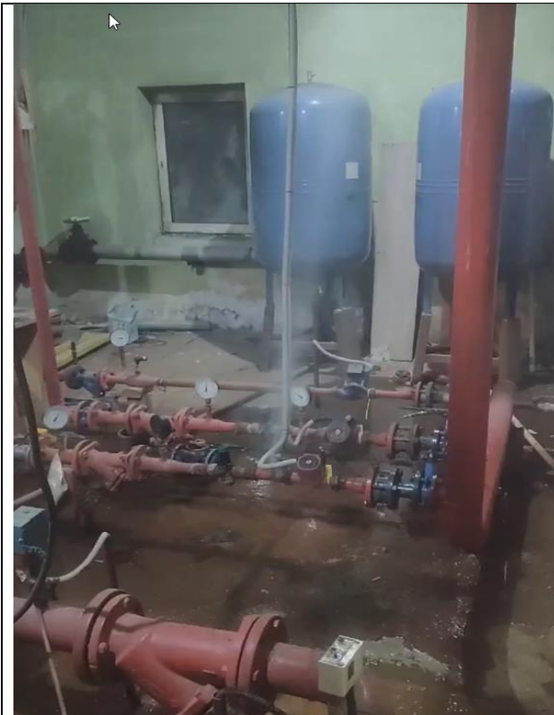
ФОТО №1 (Протечка в индивидуальном тепловом пункте (ИТП), подающий трубопровод).
