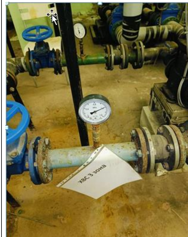
ФОТО №3 (Трубопровод ХВС в ИТП:
