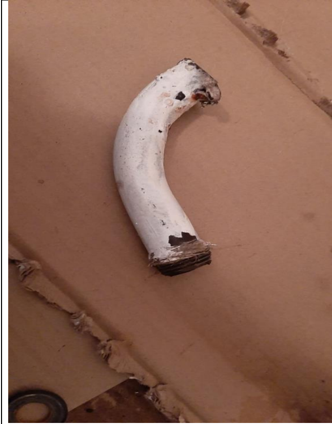
ФОТО №13 (Фрагмент срезанной трубы с внутренними отложениями ржавчины и накипи.)
