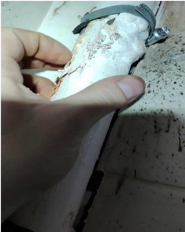
ФОТО №7 (Труба белая (краска), но внутри и снаружи — следы коррозии, налет, ржавчина, требуется замена)
