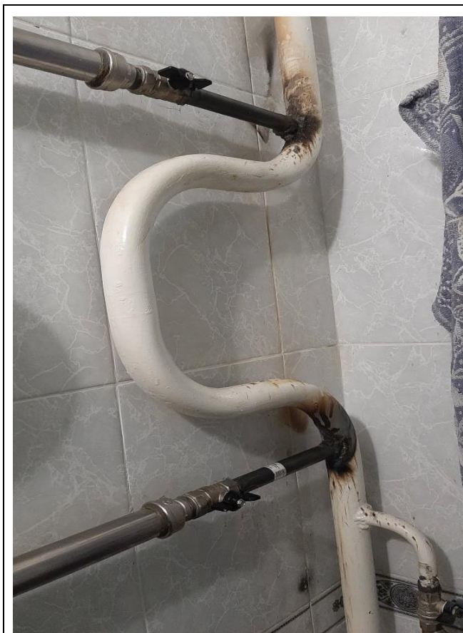
ФОТО №13 (следы коррозии)
