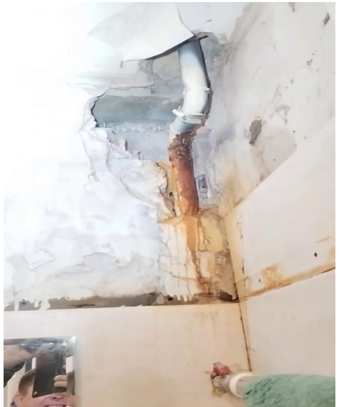
ФОТО №10 (следы коррозии на отводах)
