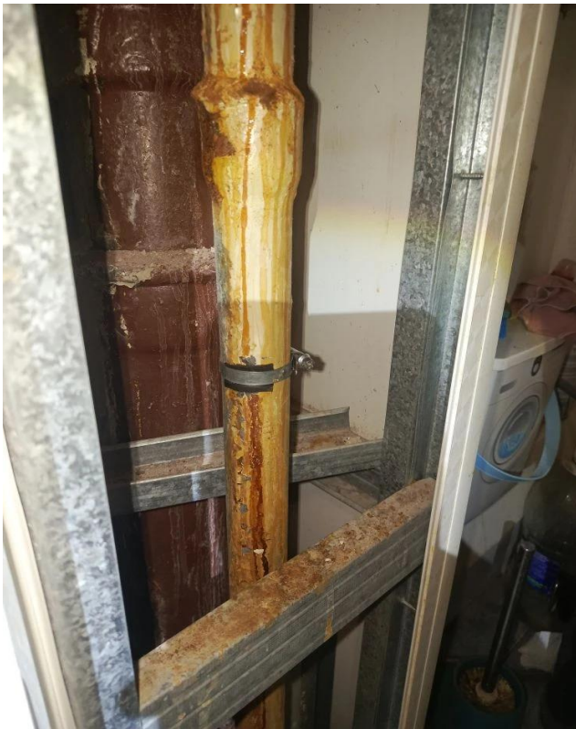
ФОТО №9 (Стойк ГВС: сильная коррозия,
