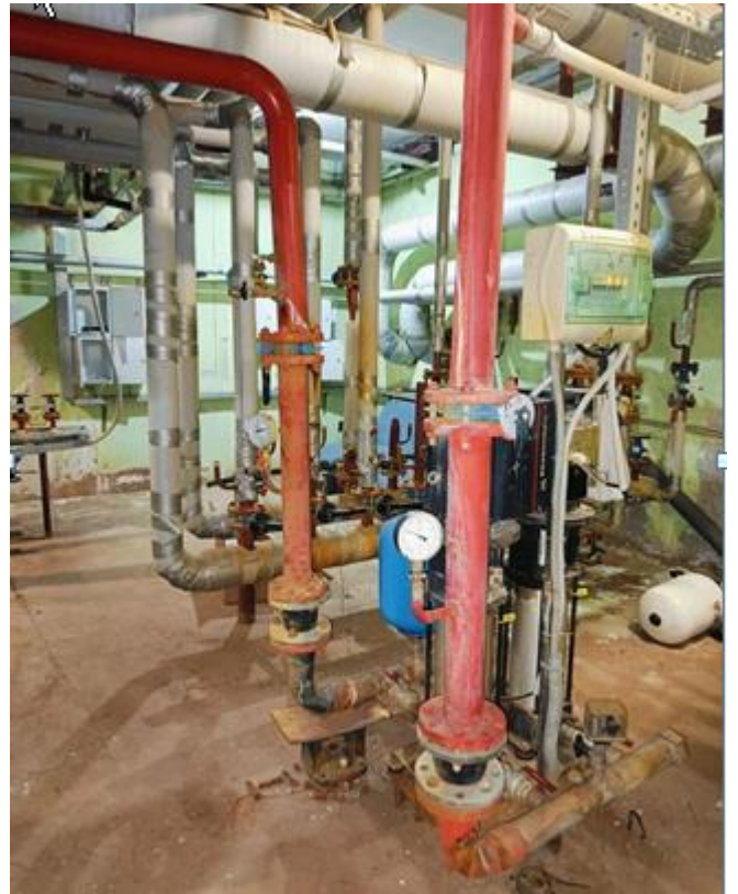
ФОТО №2 (Общий вид ИТП. Подача ГВС. расширительный бак, насосы, манометры).
