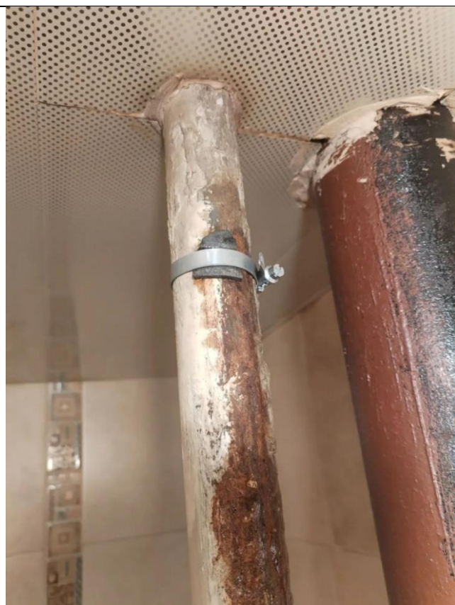
ФОТО №10 (Стояк ГВС с сильной коррозией наружной поверхности.)
