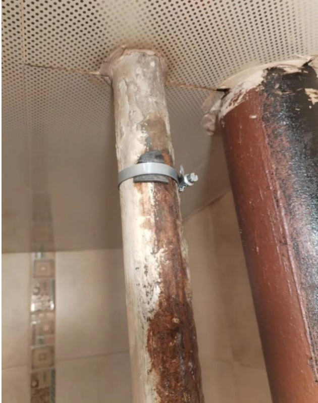
ФОТО №11 (стояк ГВС в санузле, следы коррозии)
