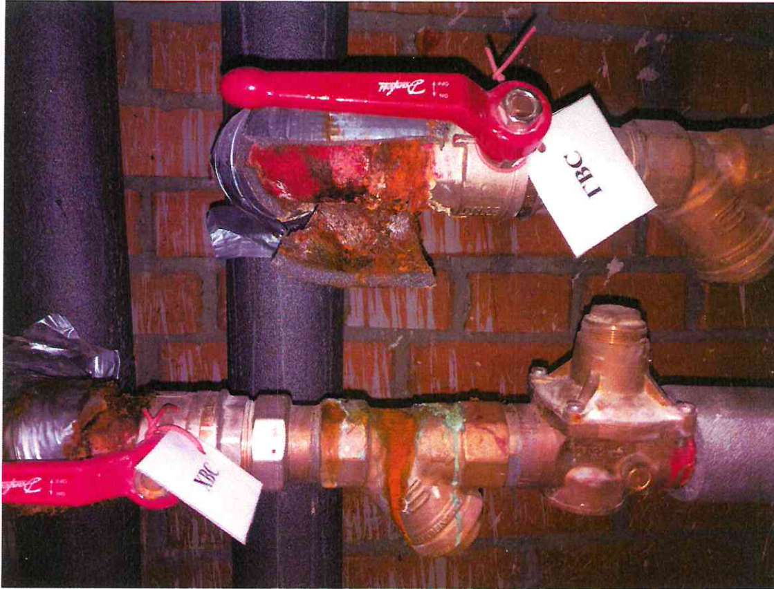
17 этаж, коррозия резьбового соединения запорной арматуры на коллекторе ХВС и ГВС:
