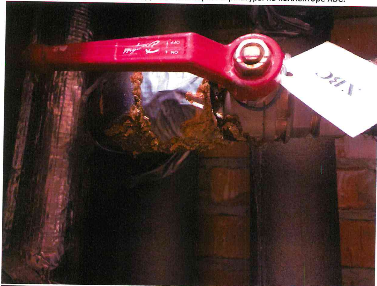
15 этаж, коррозия резьбового соединения запорной арматуры на коллекторе ХВС:
