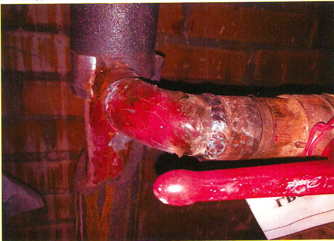
4 этаж, коррозия сварного шва трубопровода ГВС:
