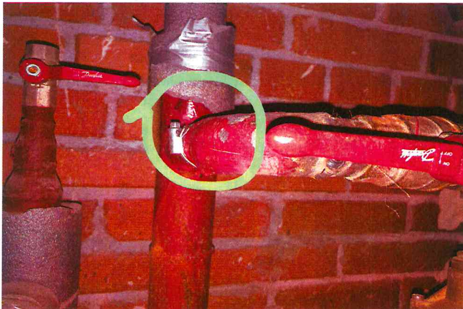
10 этаж, коррозия резьбового соединения запорной арматуры на коллекторе ГВС:
