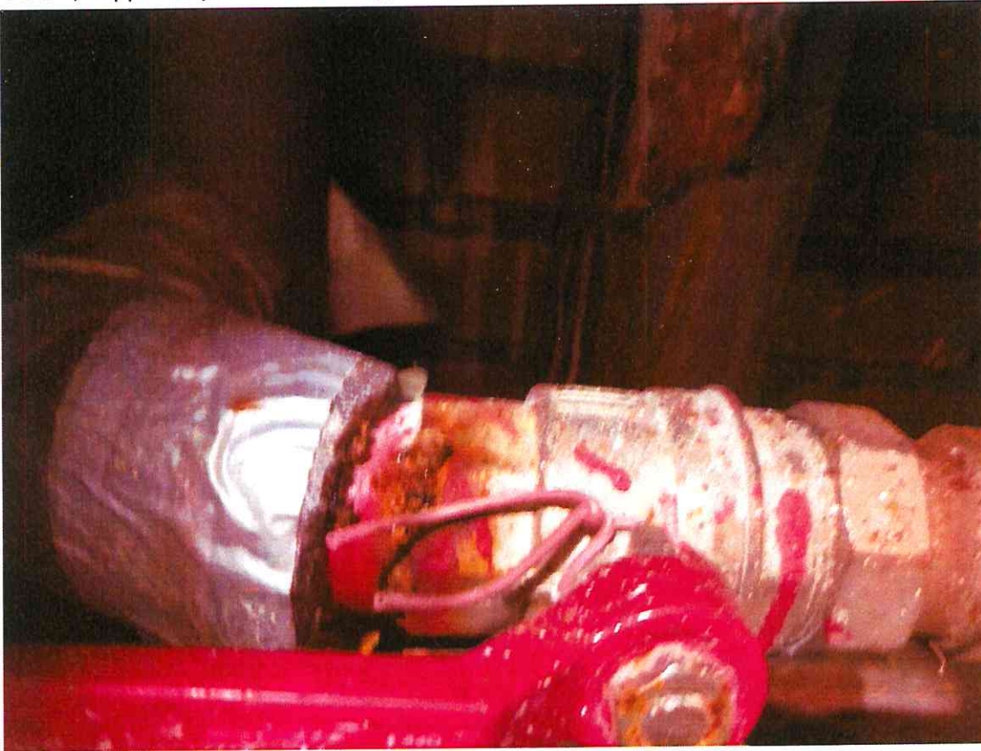
4 этаж, коррозия резьбового соединения запорной арматуры на коллекторе ГВС:
