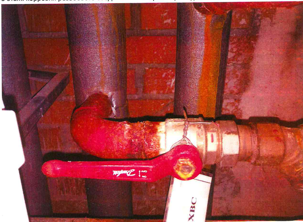
5 этаж: коррозия резьбового соединения запорной арматуры на коллекторе ХВС:
